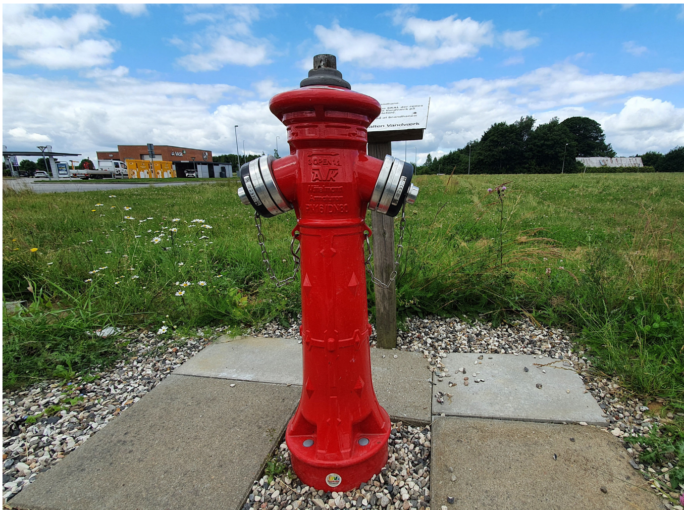
Hydrant s nainstalovanými uzávěry VIDI Cap. Použití hydrantu ovlivňuje tlak v oblasti. Proto je důležité, aby společnost věděla, kdy je hydrant používán, aby bylo možné rozlišit mezi poklesem tlaku pocházejícím z běžného používání nebo z poruchy na potrubí.
